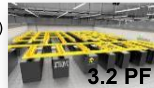
SuperMUC: IBM GAUSS/LRZ (Leibniz- Rechenzentrum) Garching, Germany
